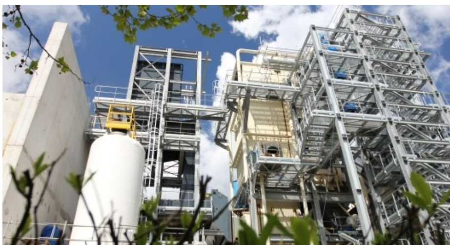
Centrale biomasse de Orléans Sud La Source, photo Dalkia
